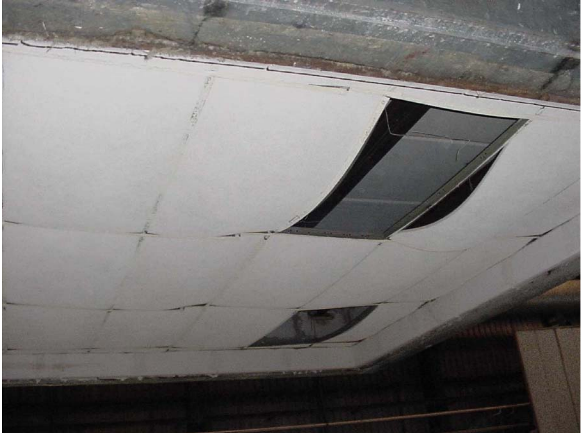
Fig. 1: Overzicht van de constructie (onderzijde van het plafond na afkoeling)
